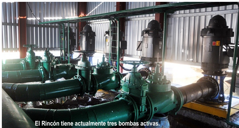
El Rincón tiene actualmente tres bombas activas.
